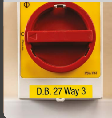
Koblings- og afbryderudstyr
